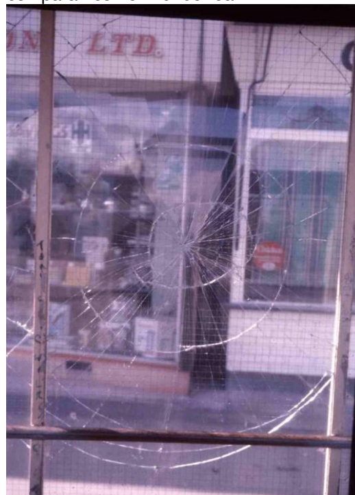
Fracturas en el vidrio de seguridad de una marquesina de parada de autobús tras el impacto de un ladrillo. (Foto de Peter Kennett)
